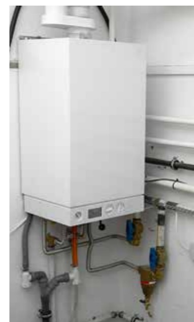
Fig. 1 Générateur de chaleur central: chaudière
