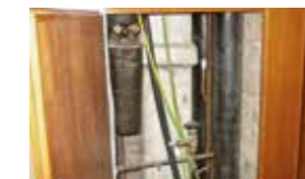
18. Tuyau de ventilation
