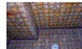
6. Revêtement mural en vinyle
