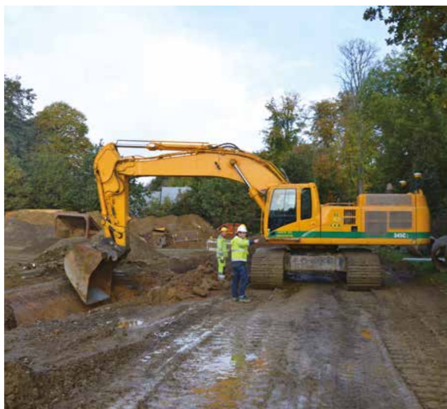
Fig. 1 Le pilotage 3D offre de nombreuses possibilités lors de la préparation des travaux d'égouttage.
