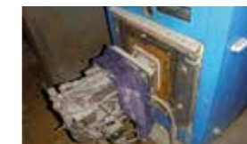
11. Joint de brûleur chaudière
