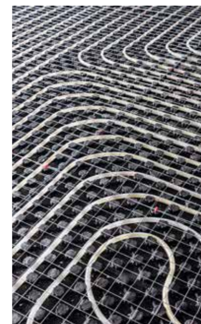
Fig. 2 Système d'émission de chaleur: sol chauffant
