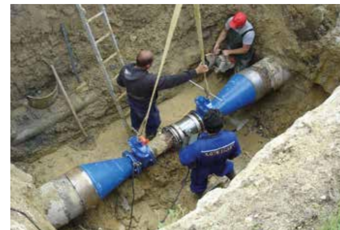
AB-F250 sur réseau de distribution eau de ville
